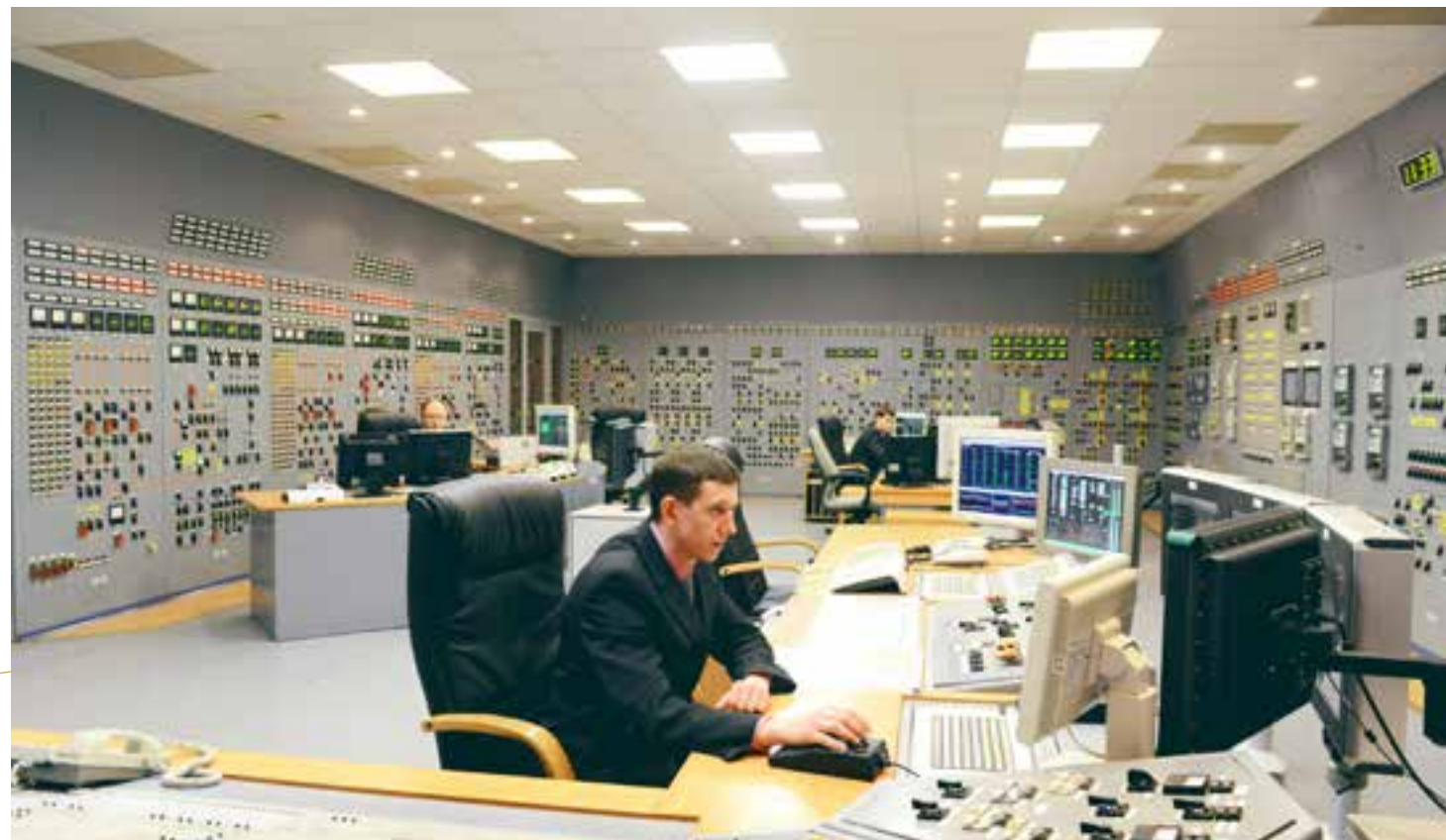
Фото БЩУ Балаковская АЭС
